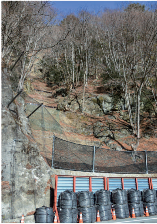
▲国道411号落石現場
