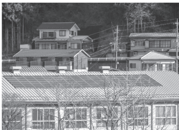
▲中学校体育館ソーラー設備
